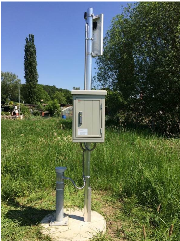
Stazione di misurazione piezometrica NAQUA-QUANT per il monitoraggio del livello delle acque sotterranee.
